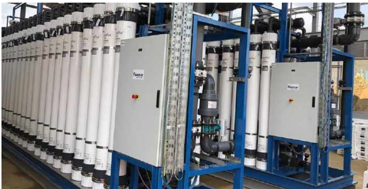
Ilustración 2 - Vista de skids de UF de la Planta San Juan.
