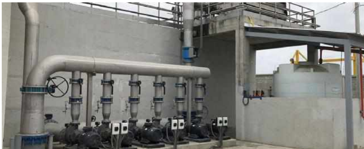
Ilustración 4 - Estación de bombeo
